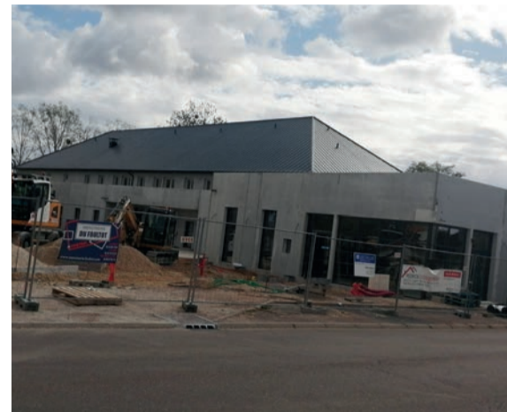
Le chantier de la maison de santé de Thorey-en-Plaine touche à sa fin.
